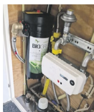
Filter geplaatst in meterkast
