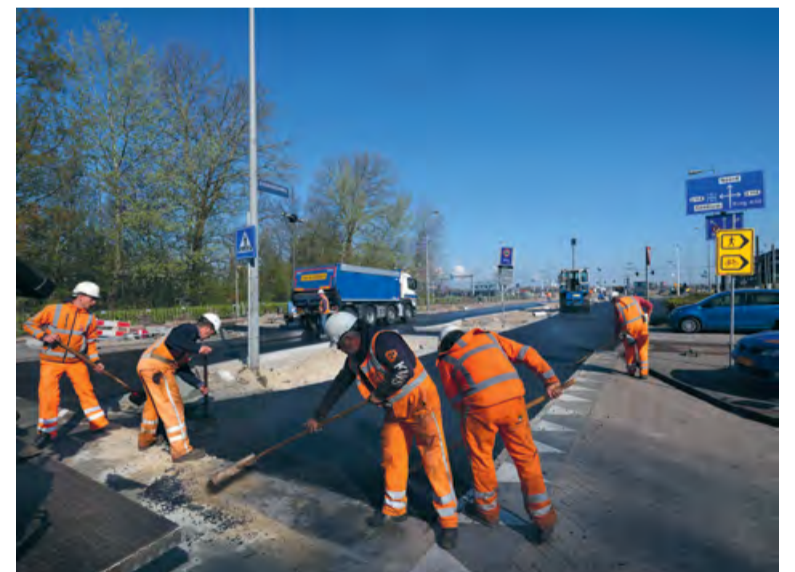
In de toekomst wordt veel meer verkeer verwacht, vooral door woningbouw op Zeeburgereiland.
